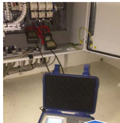
Misura dei consumi elettrici
