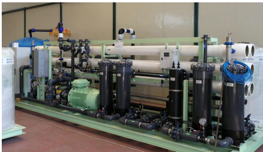
Fig. 5 : Esempio di Impianto di osmosi inversa (B&P Water Technologies)
